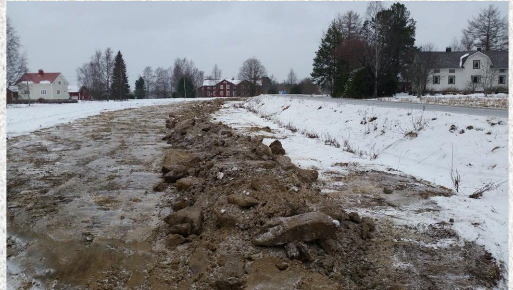
Kuortaneen varavesijohto saatiin rakentaa suurimmaksi osaksi hyvissä talviolosuhteissa, ja työn jälki olikin hyvin siistiä.
