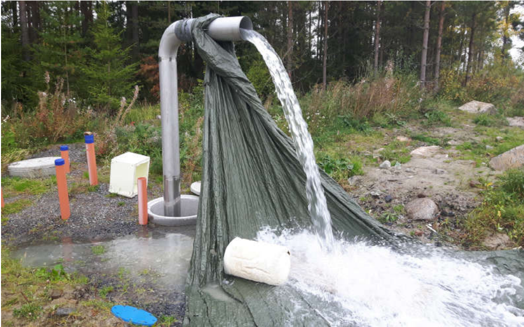
Lapuan suunnan 3. päävesijohdon "possutus" ja desinfiointi saatiin moninaisten vaiheiden jälkeen valmiiksi syyskuussa.
