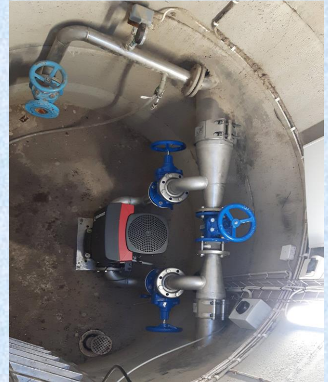
Herojan uusi paineenkorotuskoneikko
