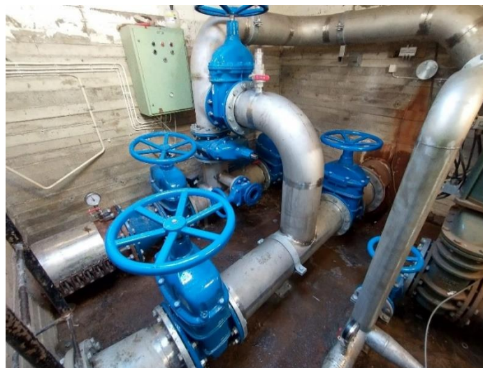
Saneerattu Kauhavan suunnan liitos- ja mittauskaivo
